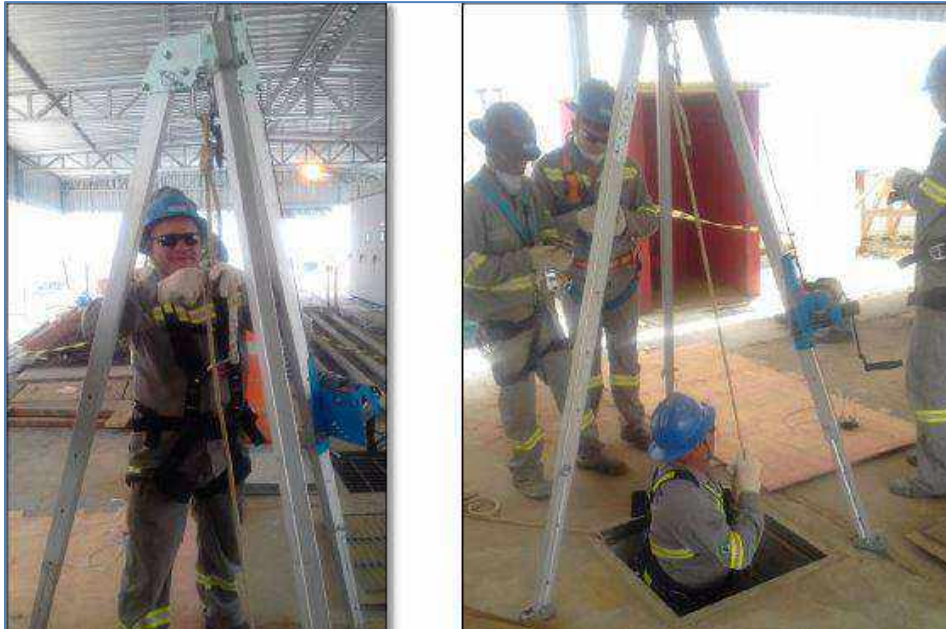
Figura 13 – Preparação e acesso a espaços confinados em subestações de padrões antigos
