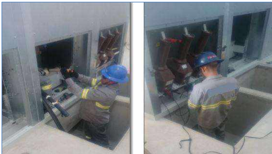
Figura 14 - Acesso aos cabos no novo padrão
