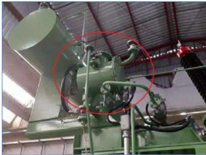
Figura 7 – Sistema de preservação do óleo do comutador sob carga
